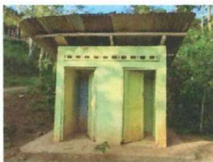
Foto 4: TECHO DEL BAÑO DE LA ESCUELA
