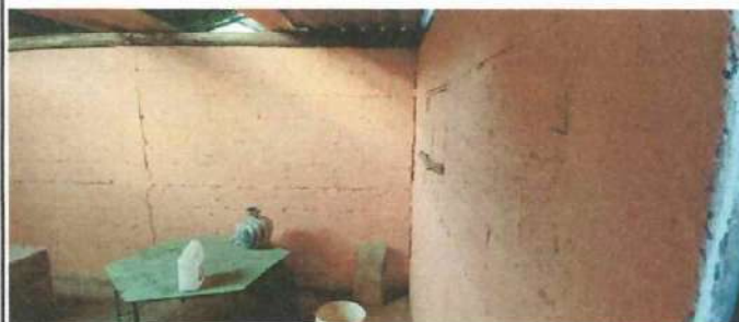
Foto 2: PARED DE COCINA DE LA ESCUELA
