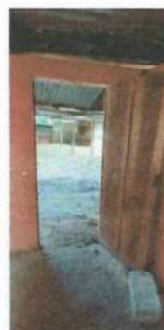
Foto 6: PUERTA COCINA DE LA ESCUELA
