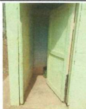
Foto 6: PUERTA COCINA DE LA ESCUELA
