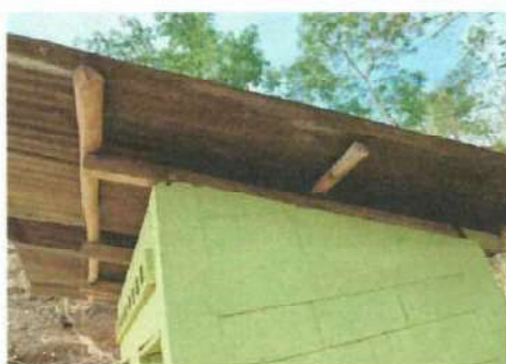
Foto 5: TECHO DEL BAÑO DE LA ESCUELA
